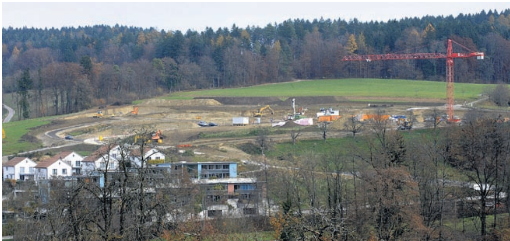
Baugruben statt weidende Kühe, Aushubhügel statt Obstbaumanlagen – oberhalb von Oberseen ist heute, ein Jahr nach Baubeginn, schon alles anders. Bild: Heinz Diener
