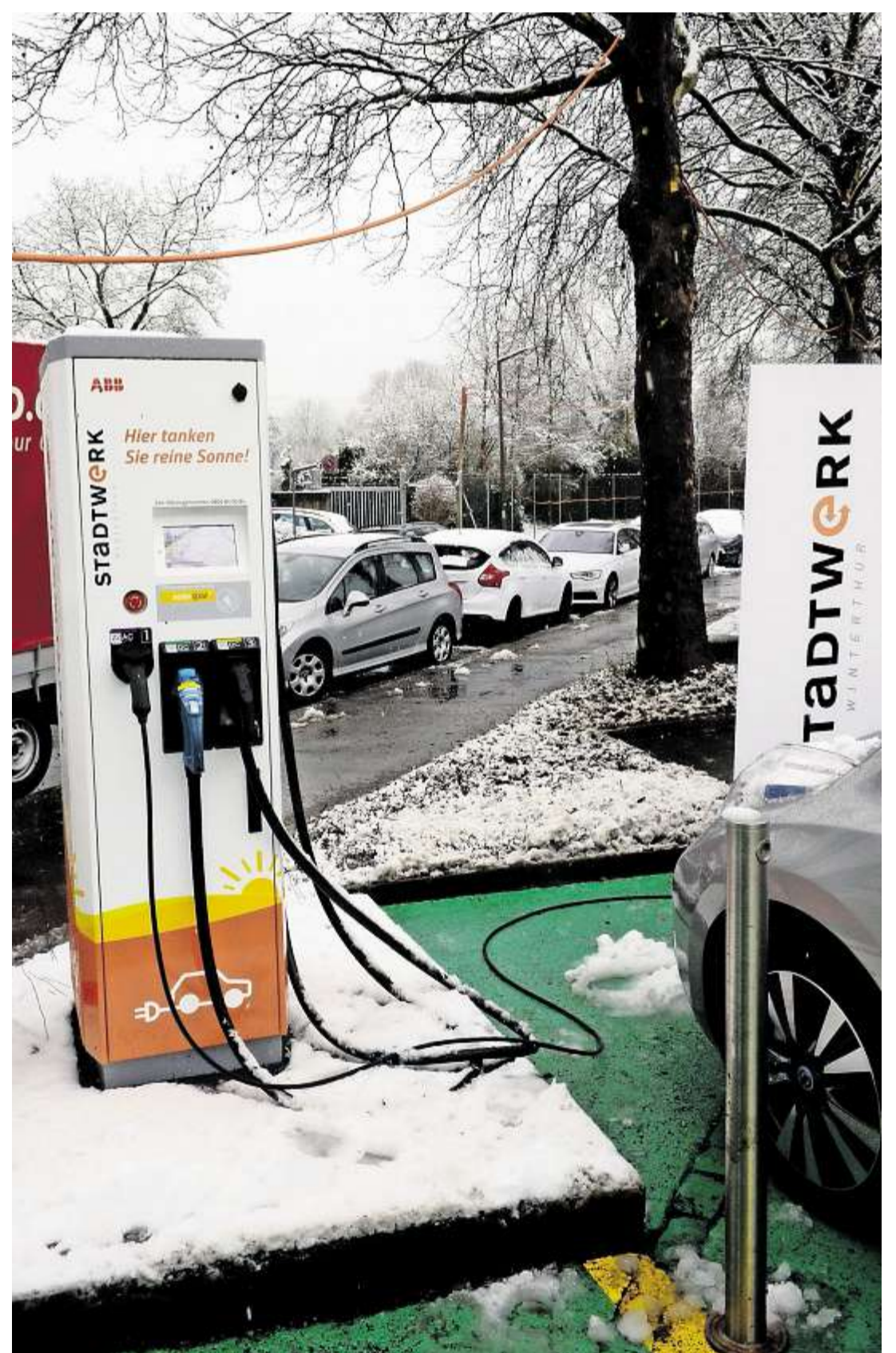
Die Elektro-Schnellladestation beim Tennis- und Squashcenter Auwiesen liefert reinen Solarstrom. Heinz Diener
